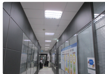
實驗室 LED 照明設備
